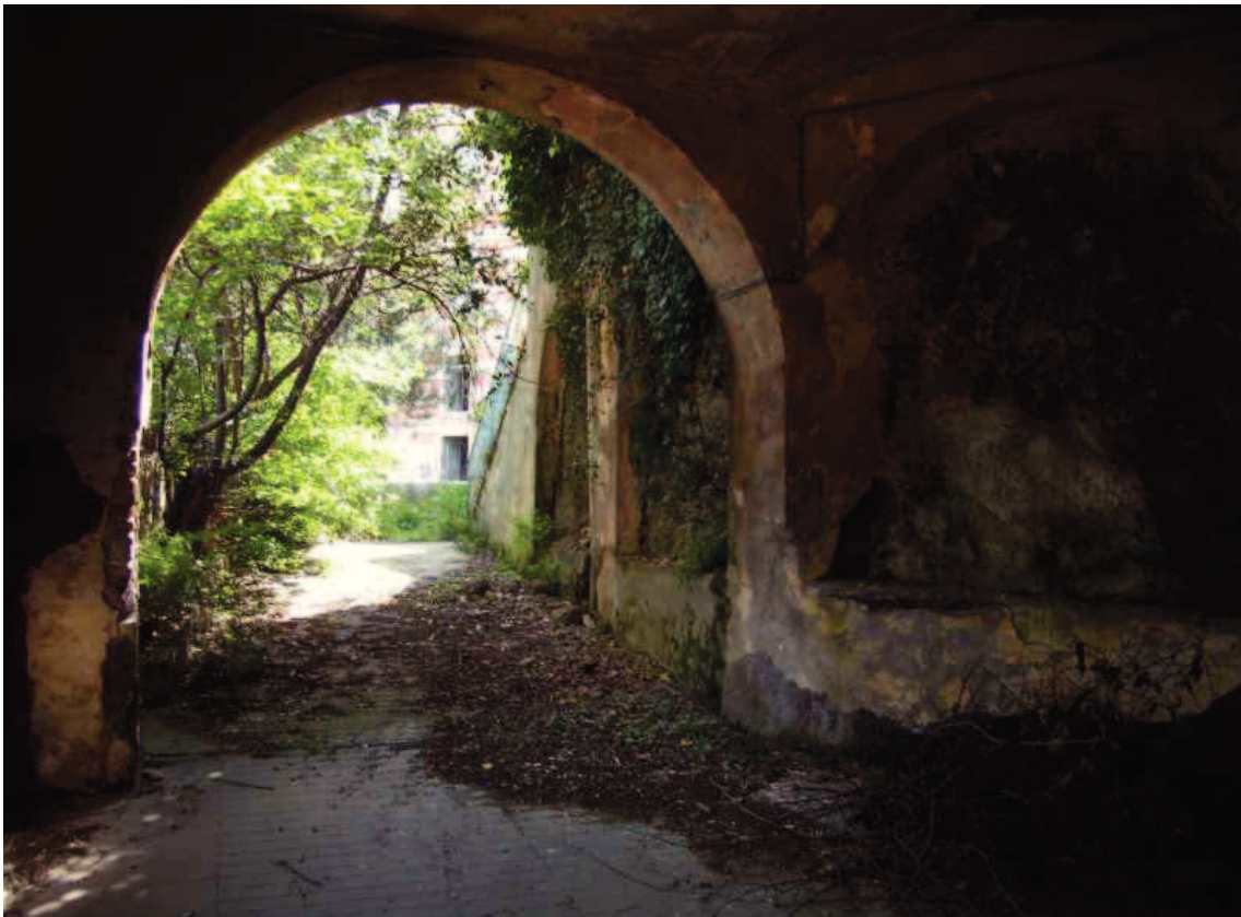
FOTO 7 – Portico fabbricato "B" e rampa d'accesso al piazzale di quota 38. Sullo sfondo fabbricato "A".
